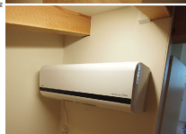
屋根ウラの空調機械室
