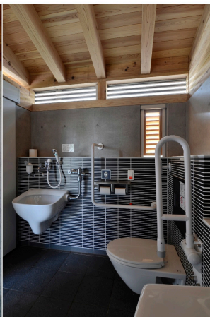
多目的トイレ内部：通風ルーバーにより通風が十分に行き渡り臭いがこもらない
